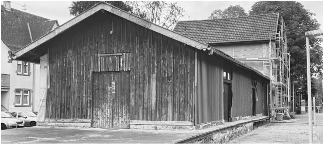
Die mit asbesthaltigen Wellplatten gedeckten Nebendächer an der kleinen Wartehalle und am Güterschopf sind sanierungsbedürftig. Fotos: Susanne Vollrath
